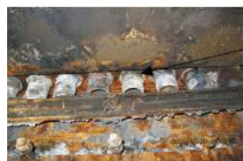
Cablajul de forță la blocul S3
