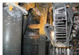
Contactor ars în blocul S3
