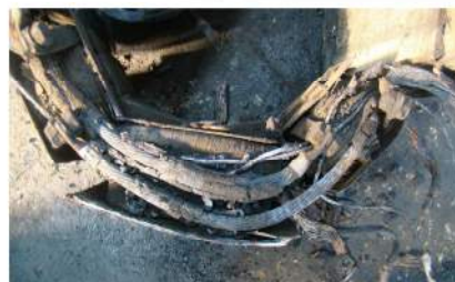
Detaliu cu cablurile de legătură a statorului în cutia de borne
