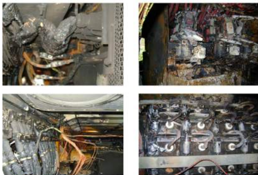
Efectele incendiului în sala mașinilor
