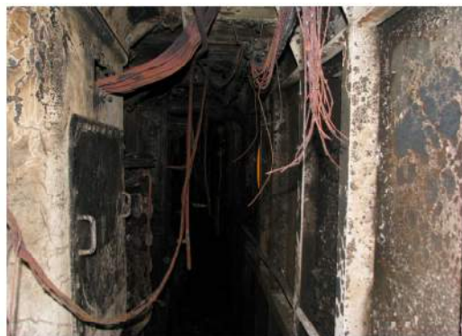
Foto 3 - Cablajele cu izolatie arsa
