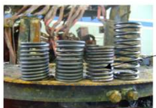
Arcul de la contactorul S4.1, respectiv de la S4.3 și S4.5 comparativ cu un arc nou
